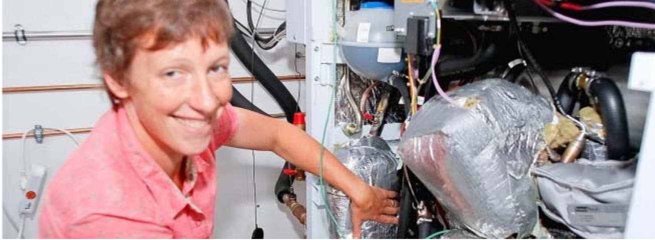
Prof. Dr. Susanne Staude am Blockheizkraftwerk.
